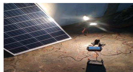
Gambar 4. Rangkaian Komponen Modul Panel Tenaga Surya (Dokumentasi Pribadi)
