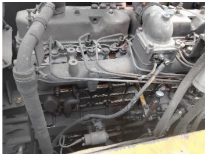
Gambar 3. Kebocoran Pada Seal dan Gasket
