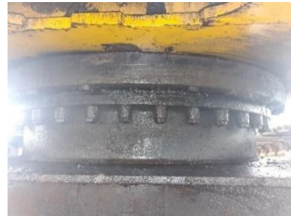
Gambar 5. Kebocoran Pada Swing Bearing
